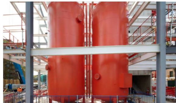
Installaties in een energiehub, Londen (door Morris+Company)
