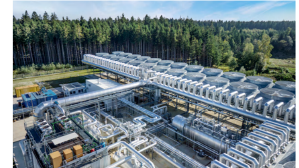
Geothermie installatie in het groen, Duitsland
